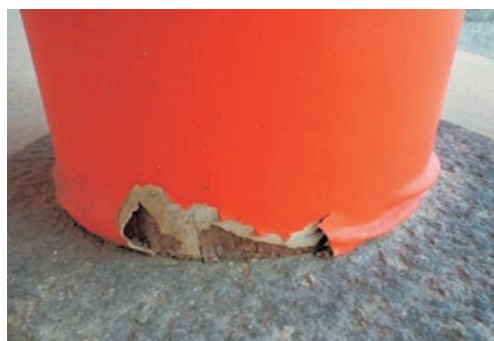
図4 柱脚塗膜不具合箇所
