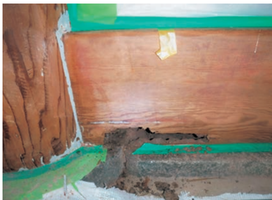
図37 月華門北側地覆修繕前
