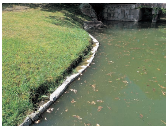
図11 出島護岸洗掘箇所
