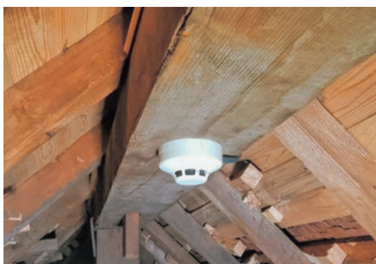
図43 小屋裏煙感知器
