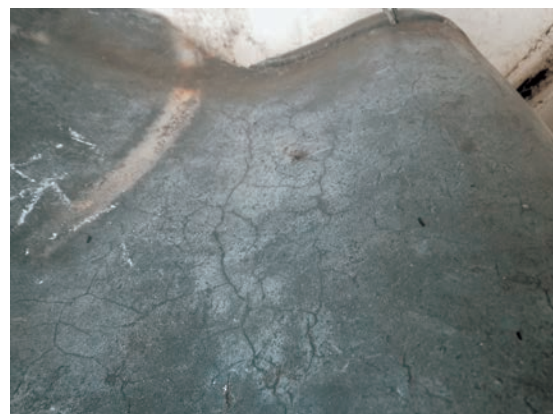
図18 獅子口瓦天端 微細なひび割れ
